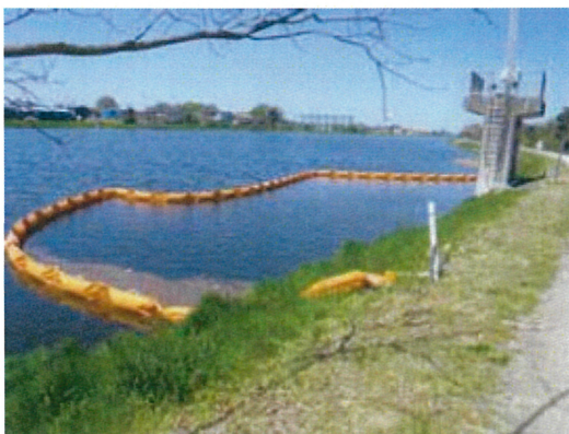
◎二郷半領揚水機場浮きスクリーン交換 【大落古利根川取入口】
