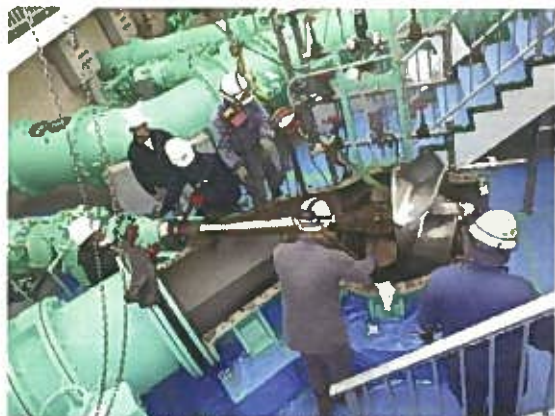
◎県営基幹水利施設管理事業 【金野井揚水機場3号ポンプ整備工事】
