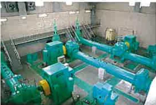
◎二郷半領揚水機場 φ800×3台 (松伏町)
