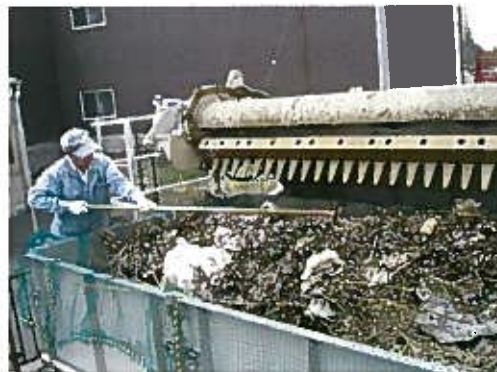
◎島中領幹線用水路(高柳分水堰)
