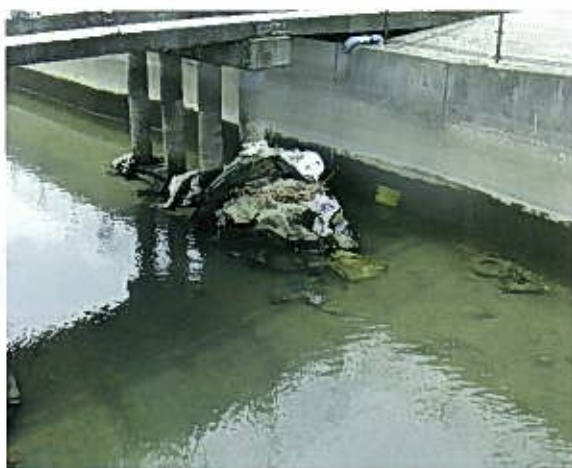
葛西用水路 橋脚に流着した塵芥 オートバイも6台捨てられていました
